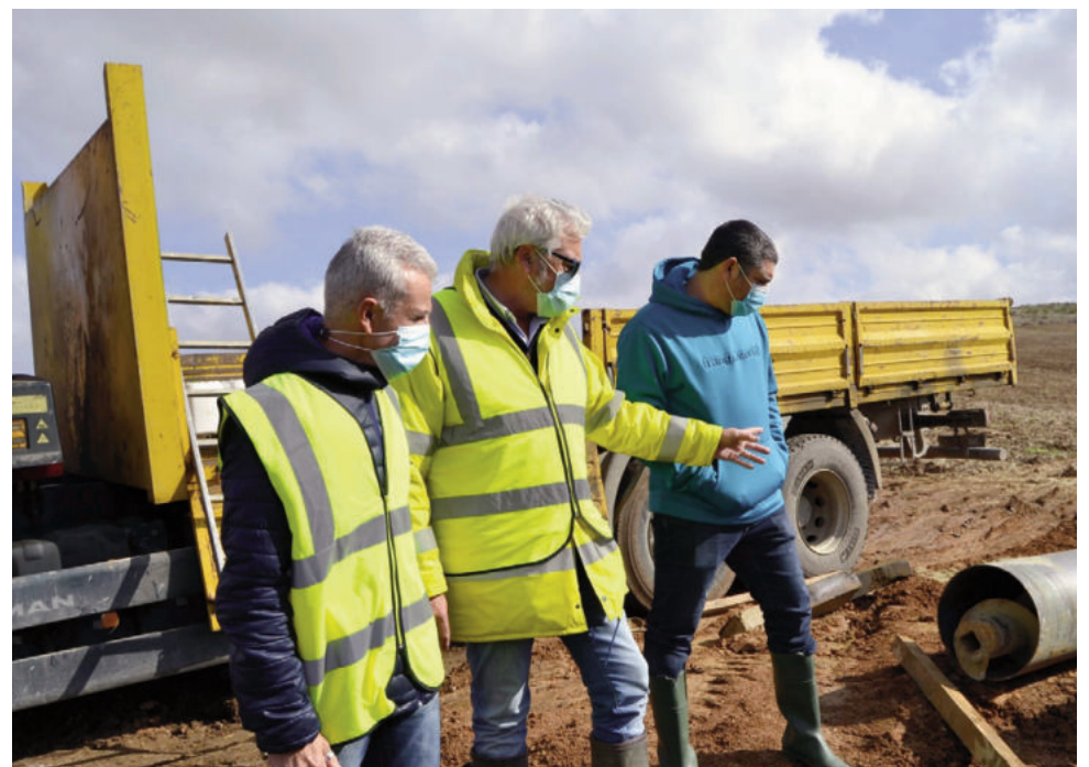
El alcalde de Campillos, Francisco Guerrero, visitando las obras del nuevo tramo de tuberías de la red de agua de Majavea. VIVA
